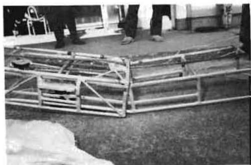
写真10 同上破壊状況
