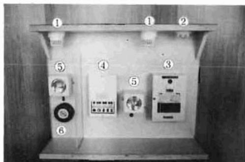
写真4 身体障害者施設用火災警報装置
