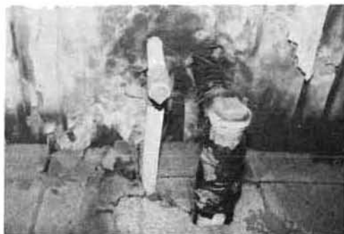
写真8 火災住戸床スラブ貫通部
