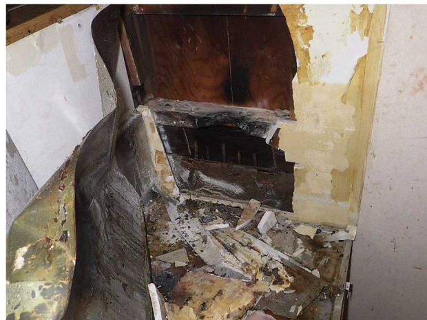
写真 7-4 壁体内の焼損状況
