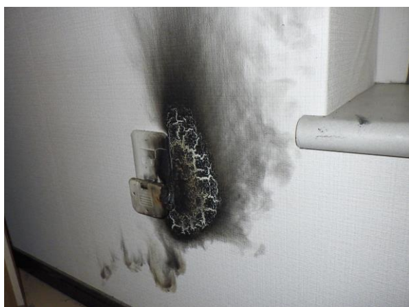
写真 18-3 出火箇所の状況
