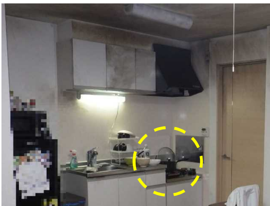
写真 9-3 出火箇所付近の状況
