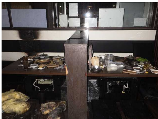
写真 27-1 焼損箇所付近の状況
