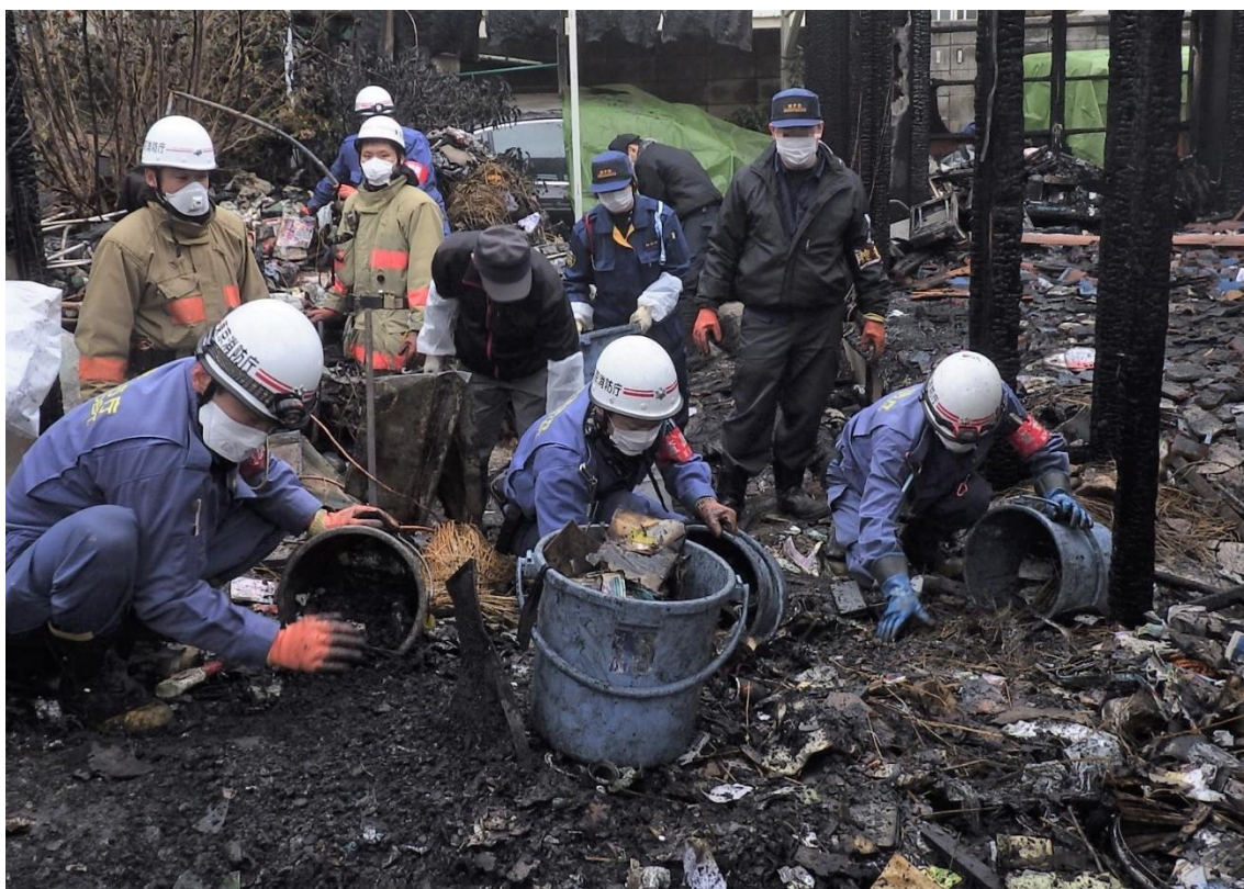
①建物火災の現場見分状況（3月）
