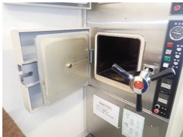
写真 22-3 高圧蒸気滅菌機の焼損状況
