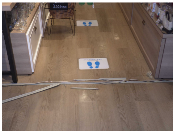
写真 20-1 出火箇所付近の状況
