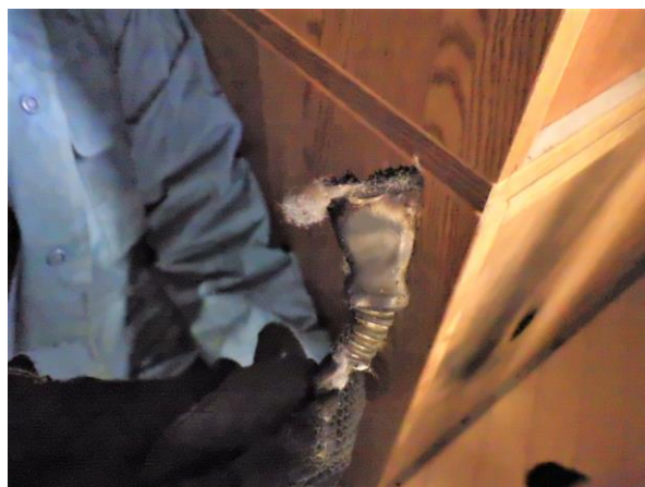
写真 18-4 焼損したプラグ部分の状況
