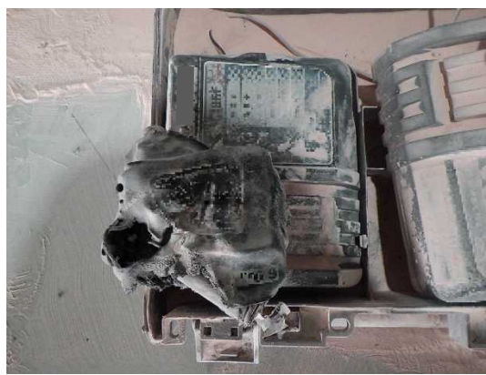
写真 16-2 出火したバッテリーの状況
