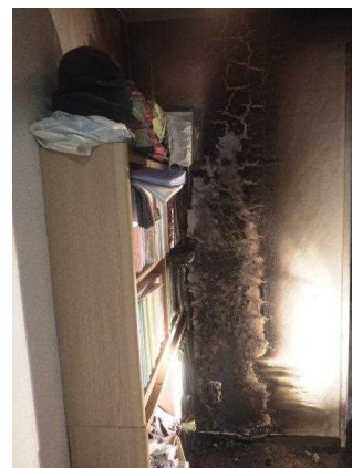
写真 13-1 焼損した居室の状況
