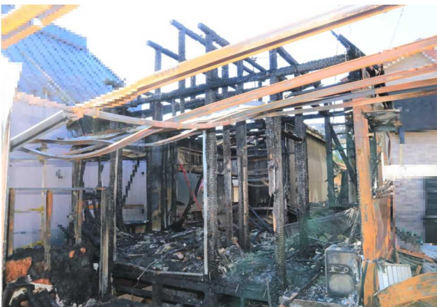
写真 25-1 焼損した倉庫の状況
