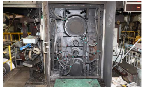
写真 30-2 出火箇所付近の状況
