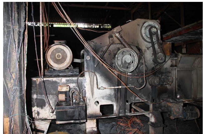
写真 28-2 破砕機の焼損状況
