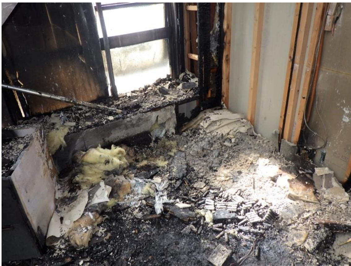
①出火した居室の焼損状況（3月）
