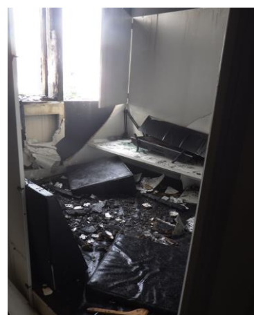
写真 32-1 焼損した客席状況
