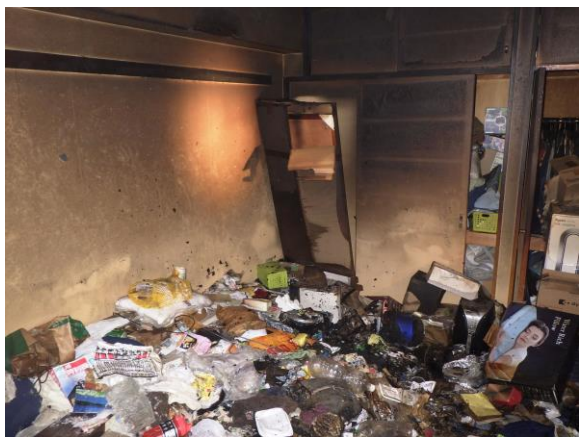
写真 18-5 出火室の焼損状況
