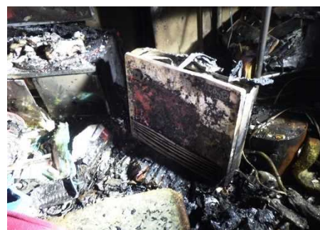
写真 11-1 出火箇所の状況
