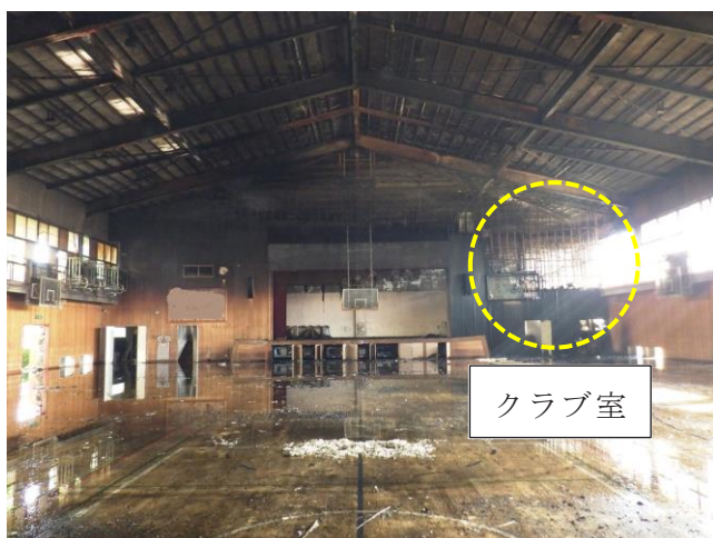
写真 23-1 体育館の焼損状況
