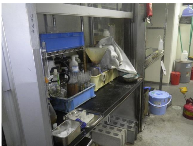
写真 23-3 実験室の焼損状況
