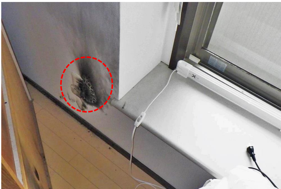
⑨家具背面にあるマルチタップの トラッキングにより出火した火災（4月）
