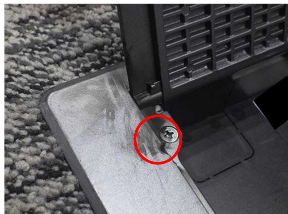
写真 26-4 フロアコンセント付近の焼損状況
