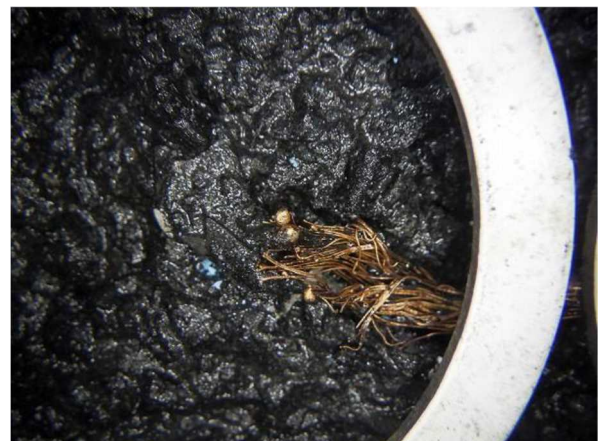
写真 25-2 焼損したコードの短絡状況
