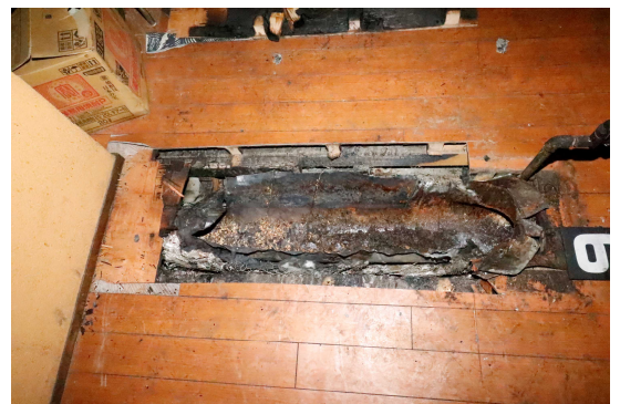
写真 19-4 客席下ダクトの焼損状況
