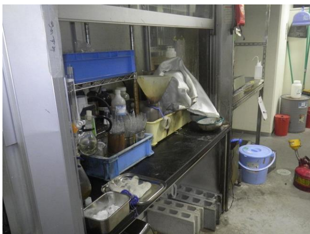
写真 23-3 実験室の焼損状況
