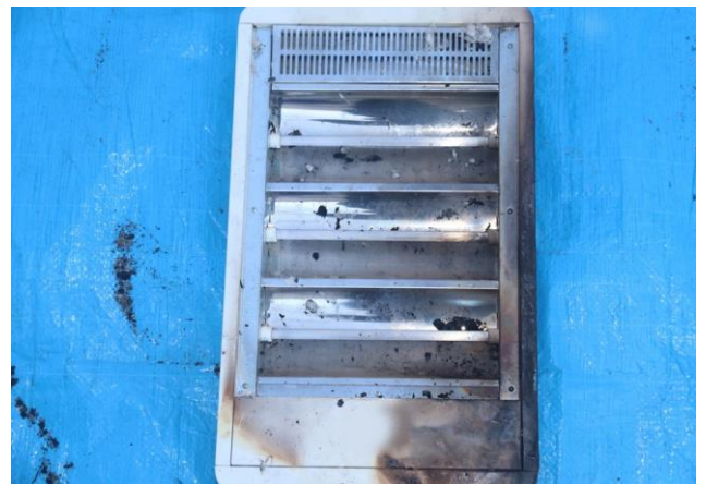
写真 18-2 電気ストーブの焼損状況
