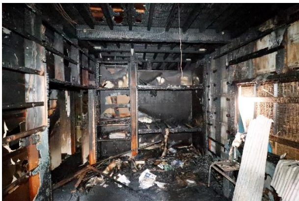
写真 6-3 居室の焼損状況
