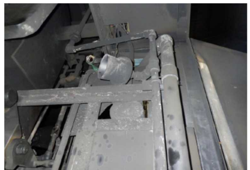
写真 30-3 二酸化炭素消火設備の状況
