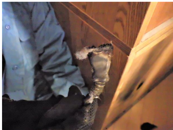
写真 18-4 焼損したプラグ部分の状況
