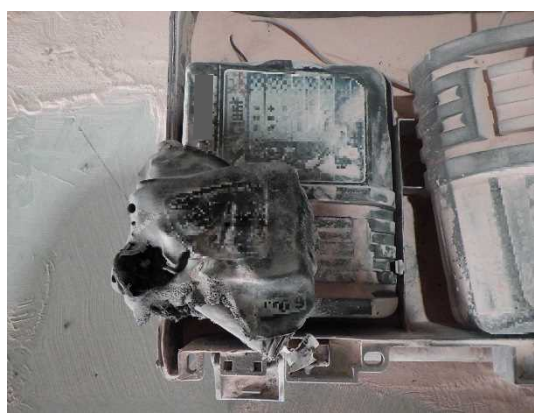
写真 16-2 出火したバッテリーの状況
