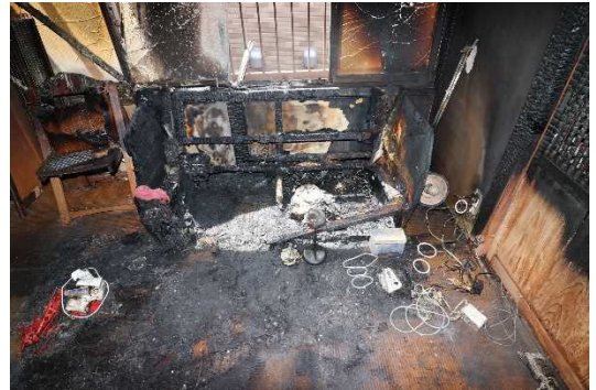
写真 14-3 居室内の焼損状況
