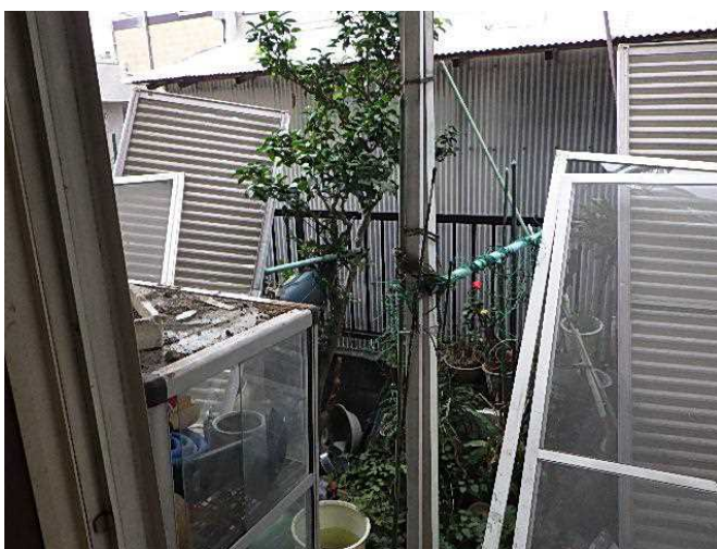
写真 12-1 爆発による窓ガラス等の破損状況
