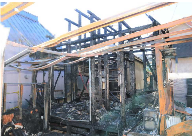
写真 25-1 焼損した倉庫の状況
