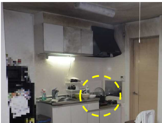
写真9-3 出火箇所付近の状況
