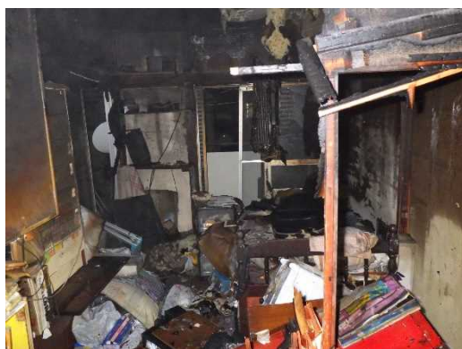
写真 14-6 居室内の焼損状況
