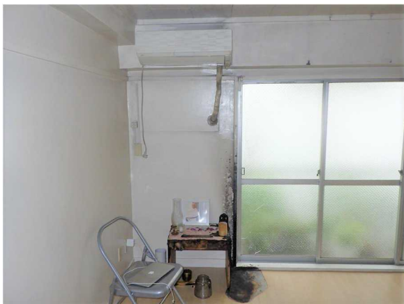
写真 5-1 木製台付近の焼損状況
