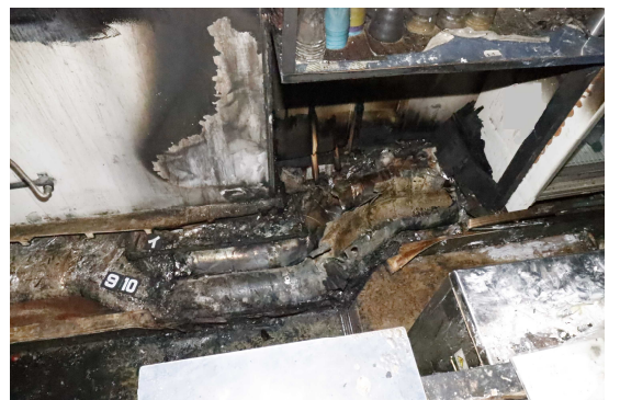
写真 19-5 ダクト内の焼損状況
