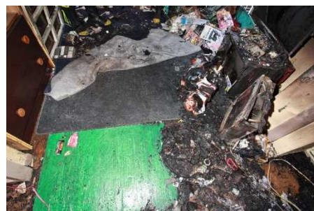
写真 11-2 居室の焼損状況
