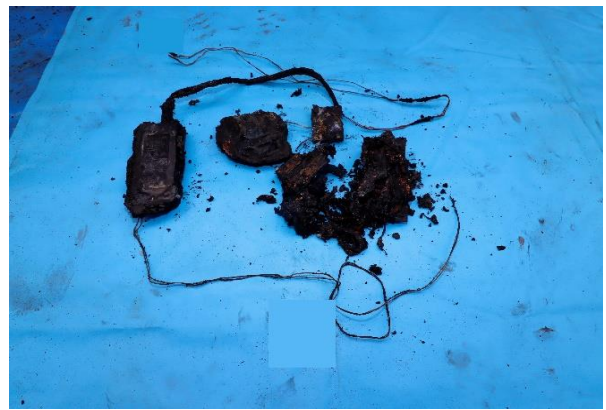
写真 6-4 バッテリーの焼損状況
