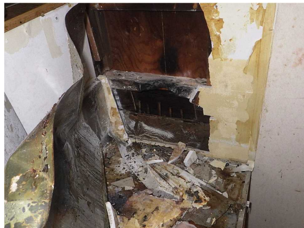
写真 7-4 壁体内の焼損状況
