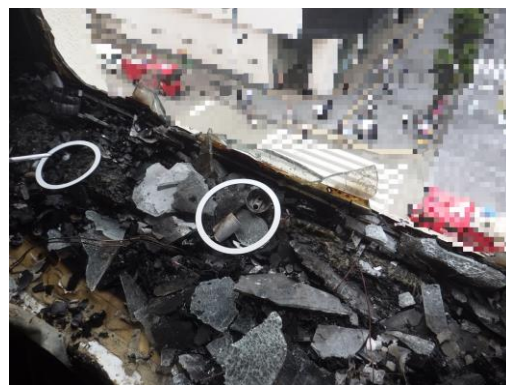
写真 32-2 蛍光灯付近の状況
