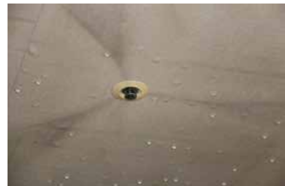
写真 31-2 スプリンクラーの作動状況
