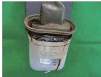
写真 26-3 進相コンデンサの焼損状況
