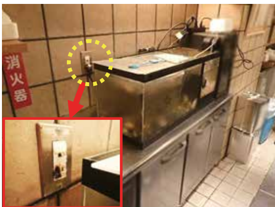
写真 6-1 壁付コンセント周辺の焼損状況
