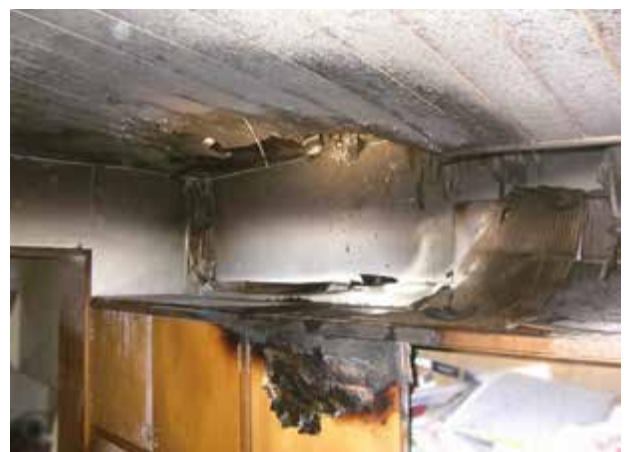
写真 12-6 天井の焼損状況
