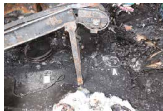
写真 25-2 ベルトコンベヤの状況
