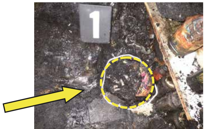
写真 15-4 焼損したごみ袋の状況
