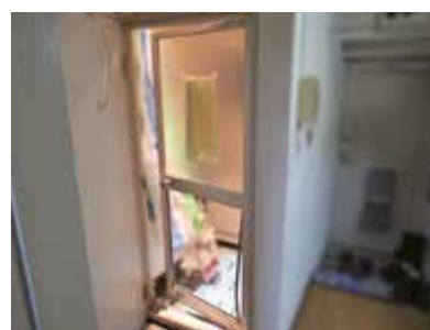
写真 12-3 浴室ドアの破損状況
