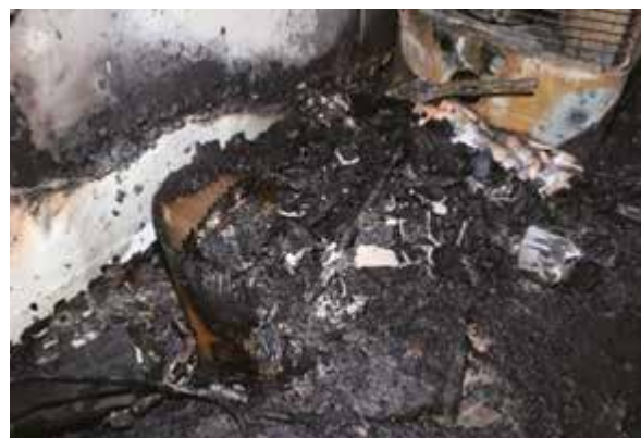
写真 2-2 段ボールのごみ箱の状況
