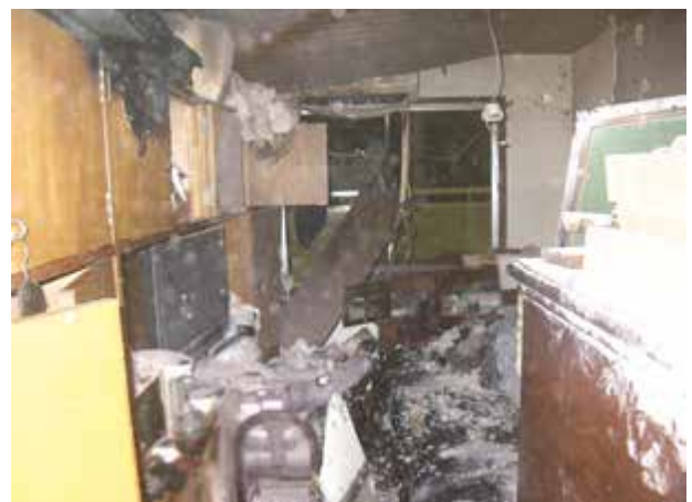
写真 12-5 居室の焼損状況
