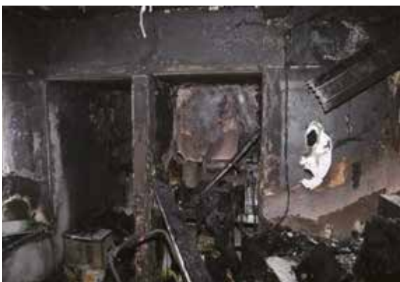
写真 2-1 出火室の状況
