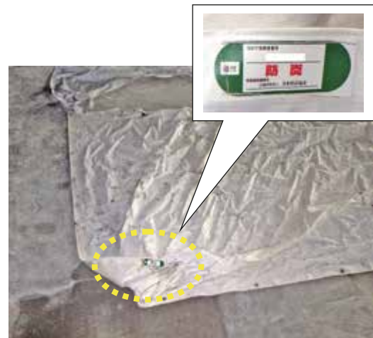
写真 18-2 防災シートの焼損状況
