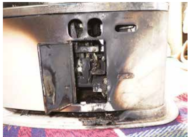
写真 8-2 操作扉内部の焼損状況
