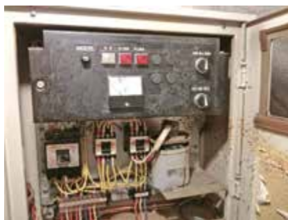
写真 26-2 操作盤の状況
