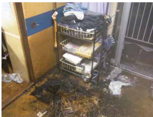
写真 14-1 焼損した居室の状況
