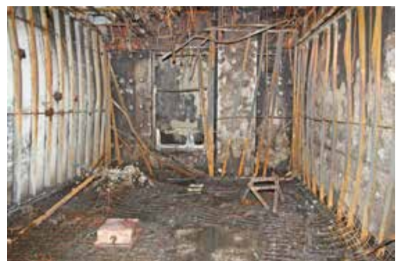
写真 16-1 出火箇所の状況
