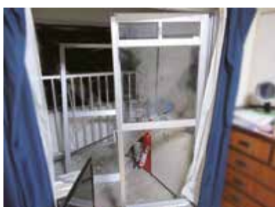
写真 12-2 サッシの破損状況
