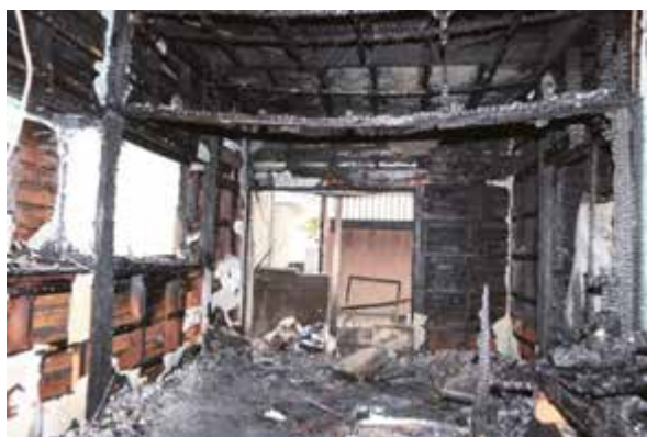
写真 2-3 出火した居室
