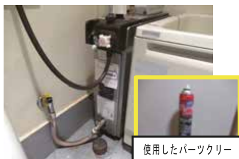
写真 12-1 バランス風呂釜の状況
