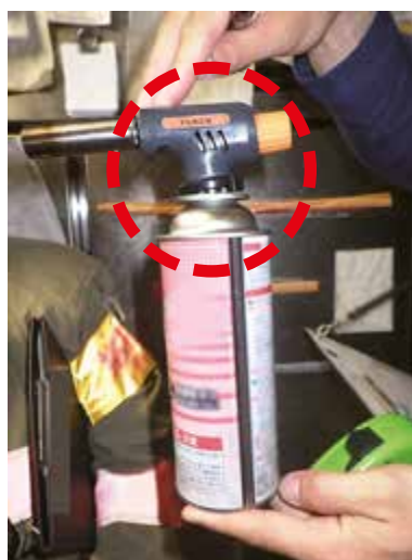
写真 11-4 ブタンガストーチバーナとカセットボンベの接続不良状況
