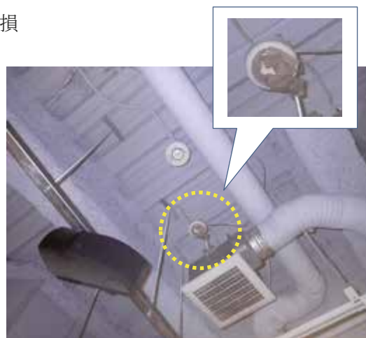
写真 31-3 覆われた感知器の状況
