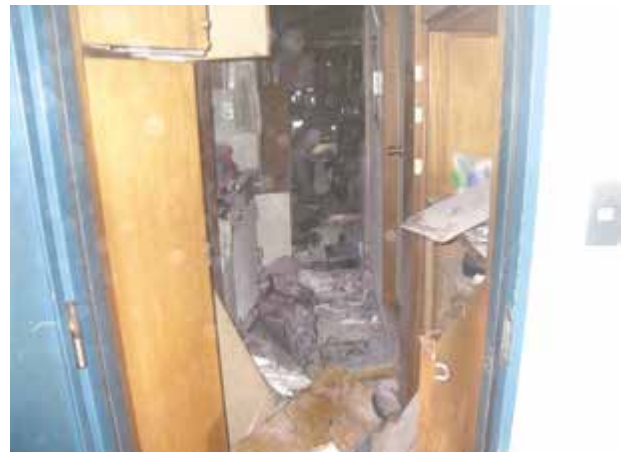
写真 12-4 玄関の焼損状況
