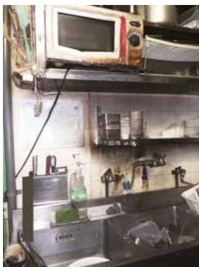
写真 11-3 調理場の焼損状況
