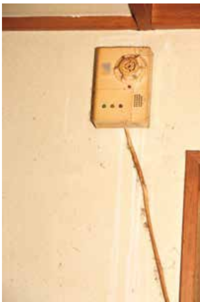
写真 19-3 1階台所の複合型住警器の設置状況
