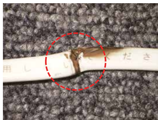
写真 27-3 コードの焼損状況
