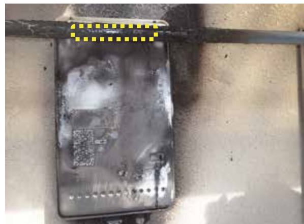
写真 7-2 給湯器の焼損状況 (黄色枠は、給湯器排気口位置)
