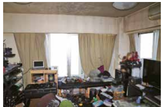
写真 31-1 出火室の状況
