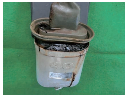
写真 26-3 進相コンデンサの焼損状況
