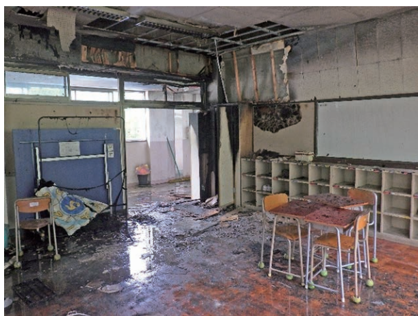
写真 24-4 教室内の状況
