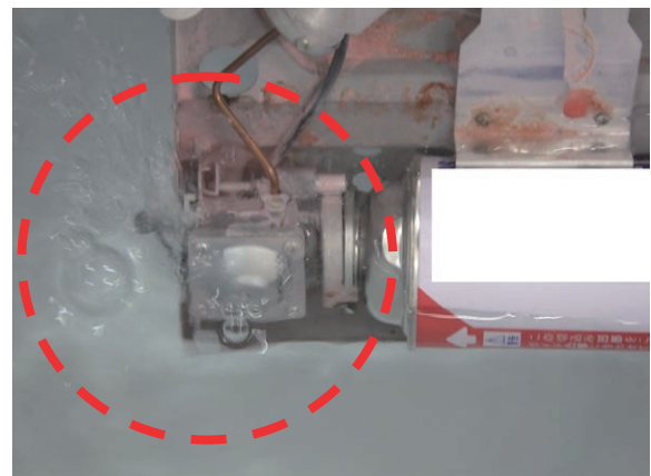
写真 11-2 水中に漏れたLPガスの気泡
