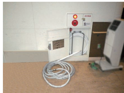
写真 32-2 補助散水栓の状況
