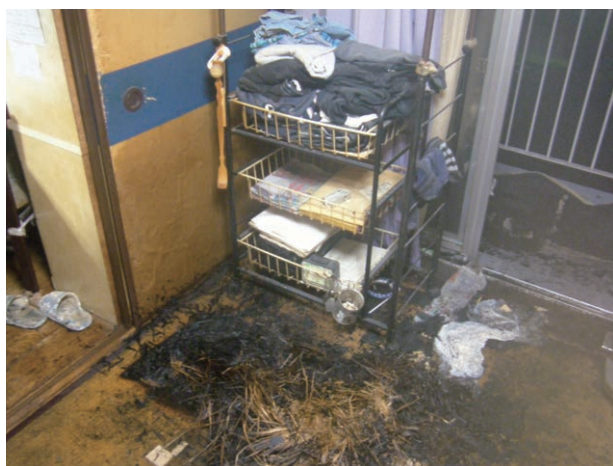
写真 14-1 焼損した居室の状況
