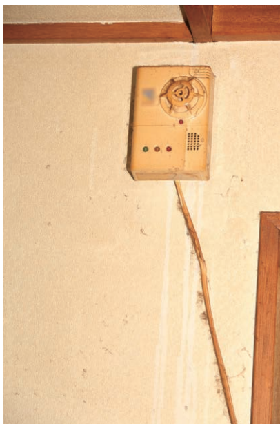
写真 19-3 1階台所の複合型住警器の 設置状況
