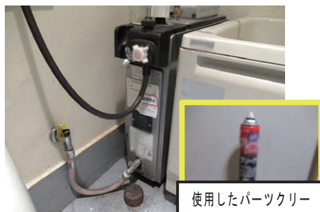
写真 12-1 バランス風呂釜の状況
