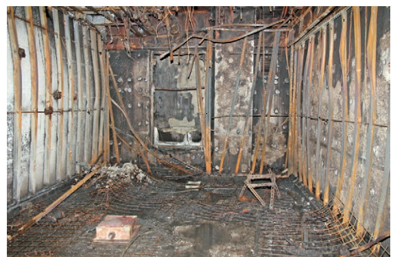
写真 16-1 出火箇所の状況
