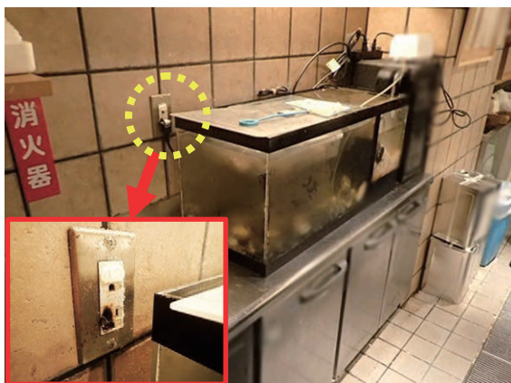
写真 6-1 壁付コンセント周辺の焼損状況
