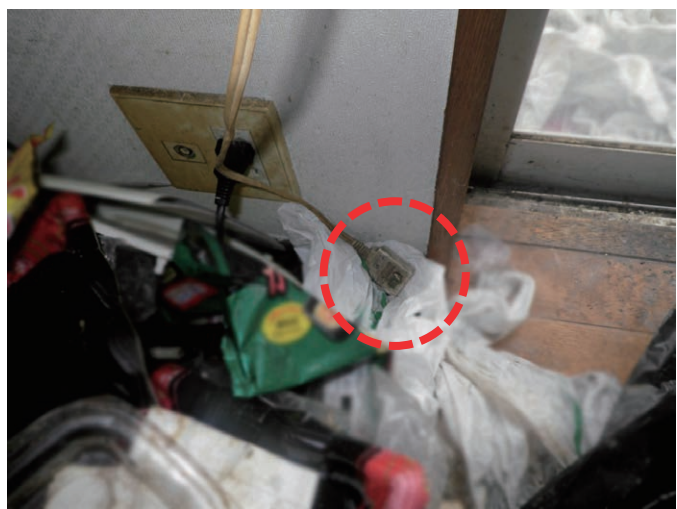
写真 19-4 外れている電源プラグの状況
