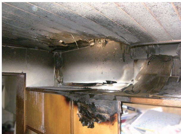
写真 12-6 天井の焼損状況
