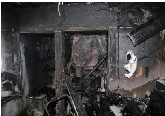
写真 2-1 出火室の状況
