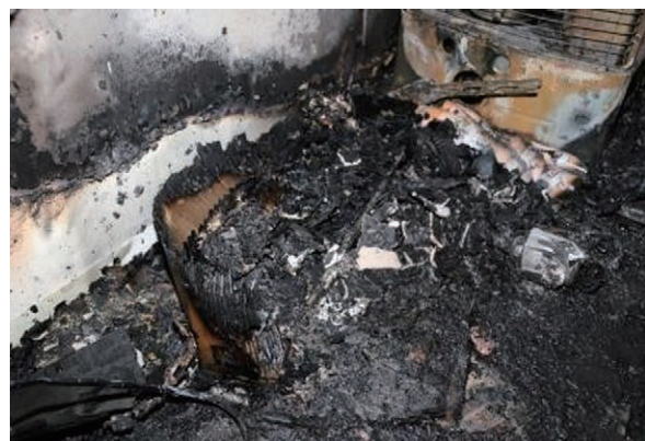
写真 2-2 段ボールのごみ箱の状況
