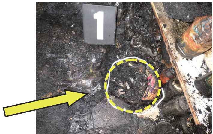
写真 15-4 焼損したごみ袋の状況
