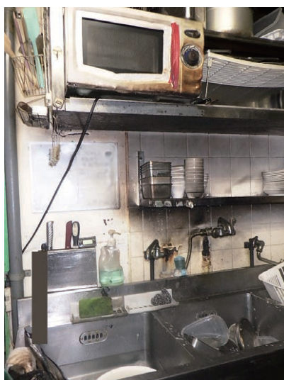
写真 11-3 調理場の焼損状況
