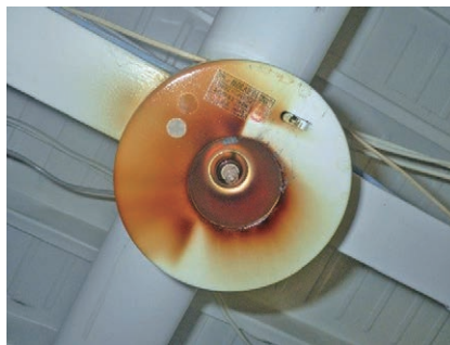
写真 21-5 非常用照明の状況
