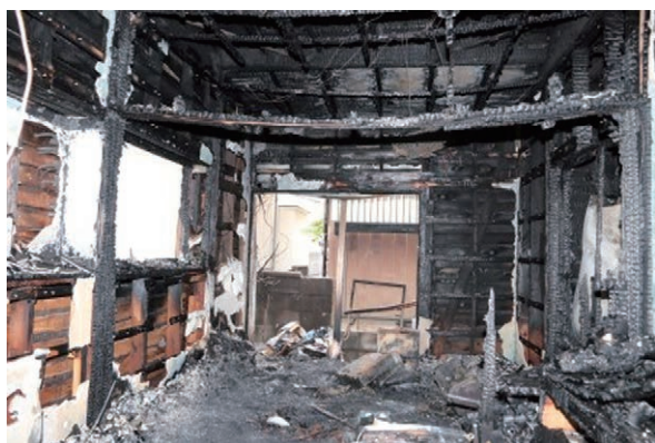
写真 2-3 出火した居室
