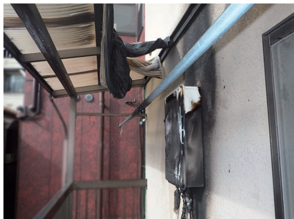
写真 7-1 給湯器周辺の状況
