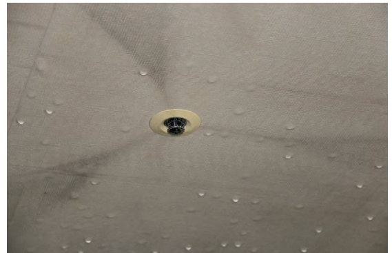
写真 31-2 スプリンクラーの作動状況
