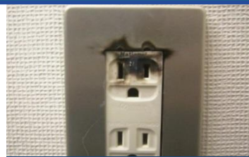
コンセントのこげ跡
