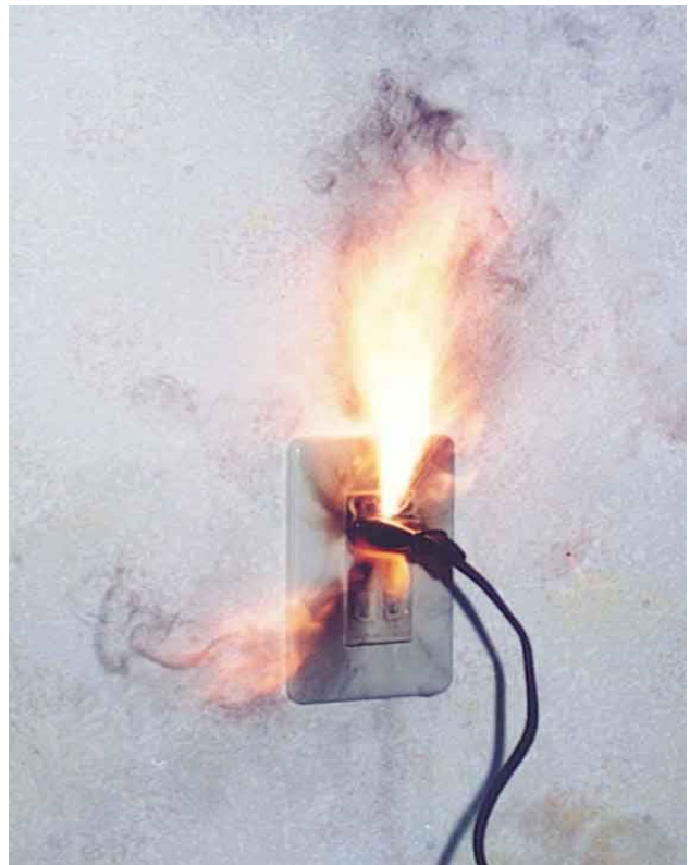
トラッキング火災！
