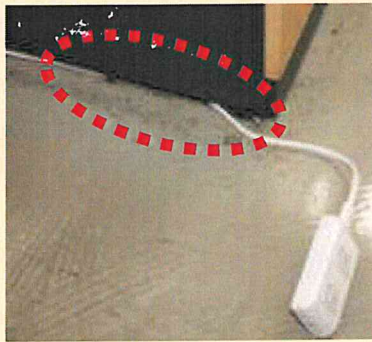
家具類の下敷き状態
