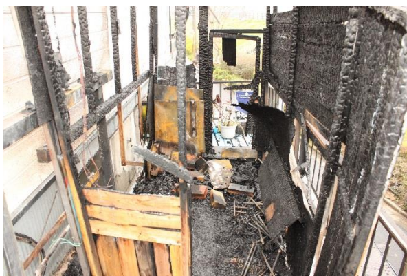
写真5 出火箇所の状況
