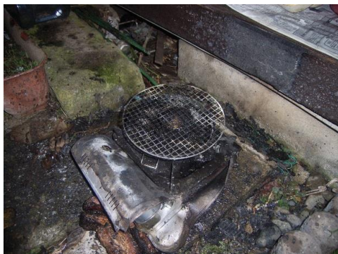
写真7 出火箇所の状況
