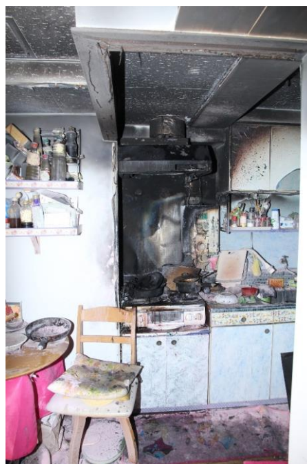
台所の焼損状況
