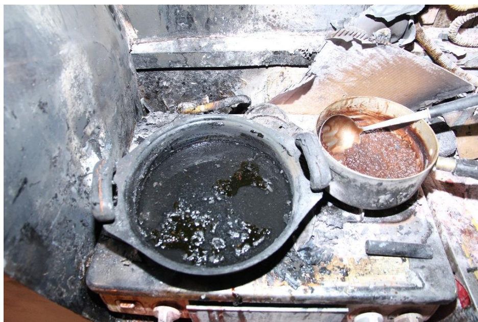
ガステーブルの焼損状況
