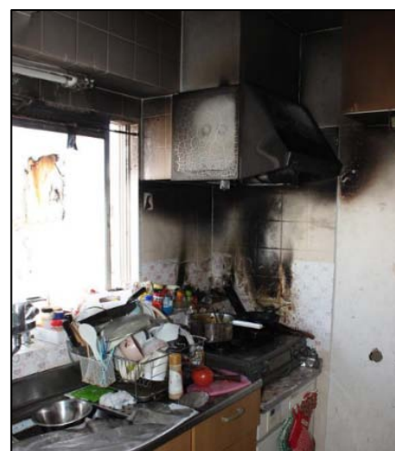
天ぷら油により発生した火災
